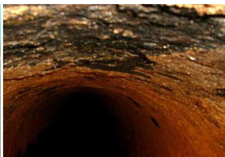
Corrosión de la tubería de impulsión principal
